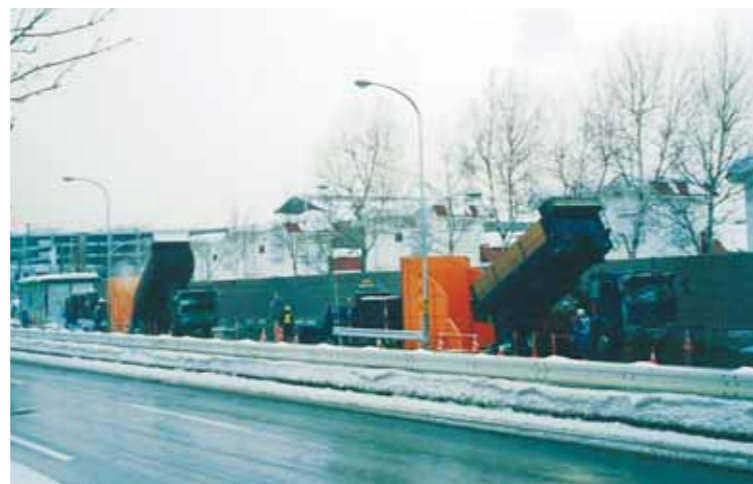
八軒下水道管投雪施設
