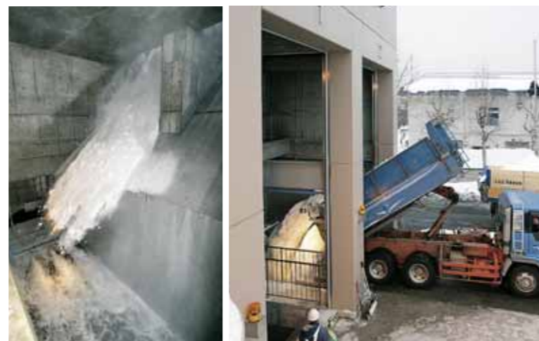
伏古川融雪管
