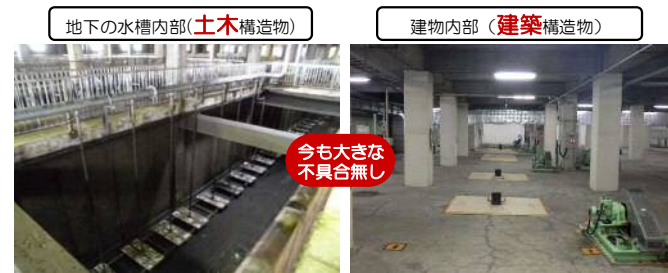
創成川水再生プラザ(1968年供用開始)
