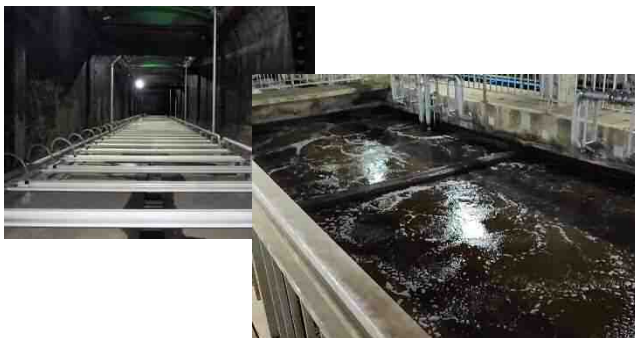
図 3-8 省エネ設備の例(超微細気泡散気装置)
