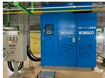
図 3-9 蒸気発電設備
