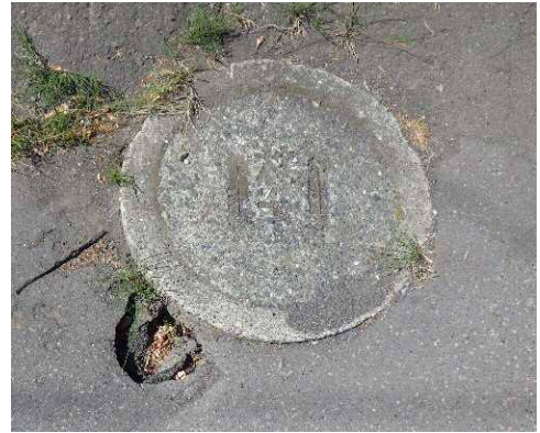
取付管に起因する道路陥没例 (公共樹と取付管の接合部のズレ)
