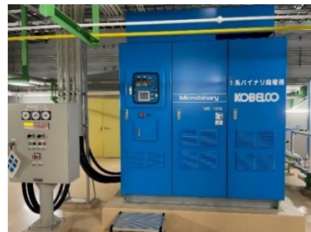
図 3-9 蒸気発電設備
