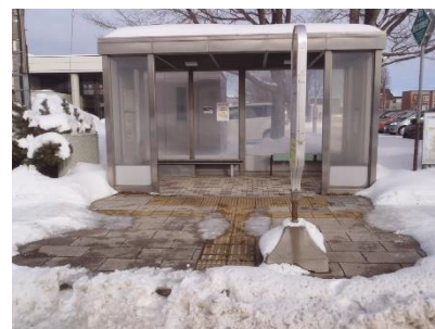
図 3-11 ロードヒーティング
