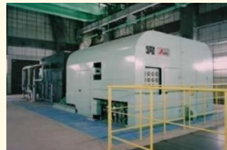
蒸気タービン発電機
