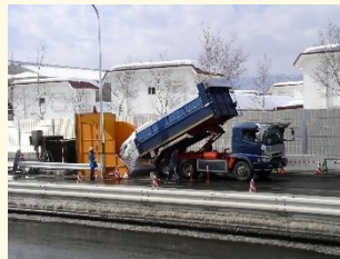
八軒下水道管投雪施設
